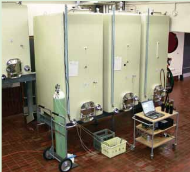
Installation de micro-oxygénation automatique avec le cylindre d'oxygène et le poste de régulation de l'apport d'oxygène.
