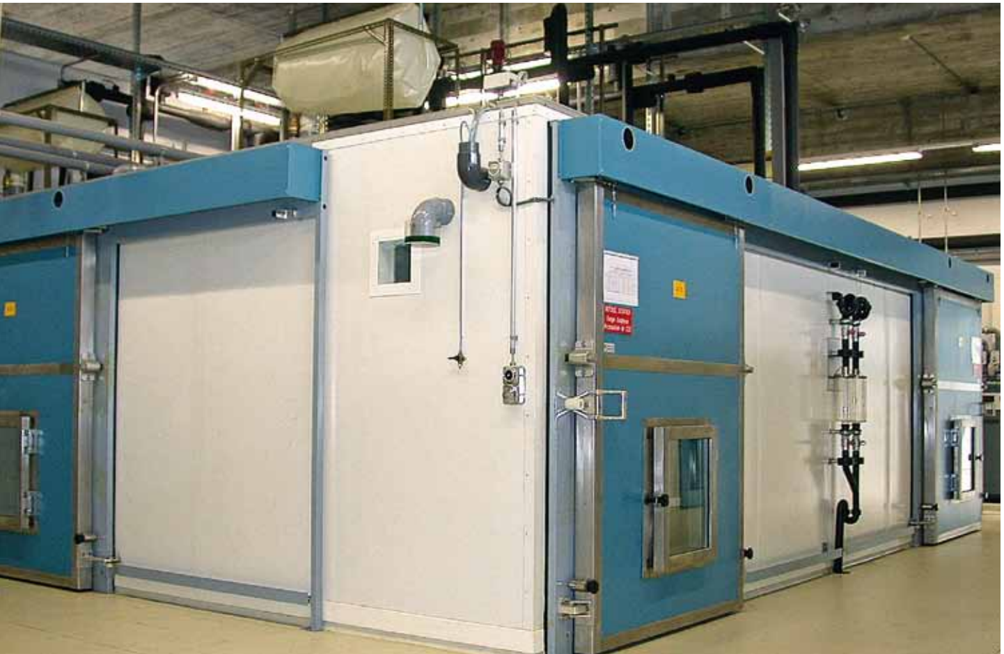
Installations frigorifiques du centre de recherche Conthey d'Agroscope ACW.
