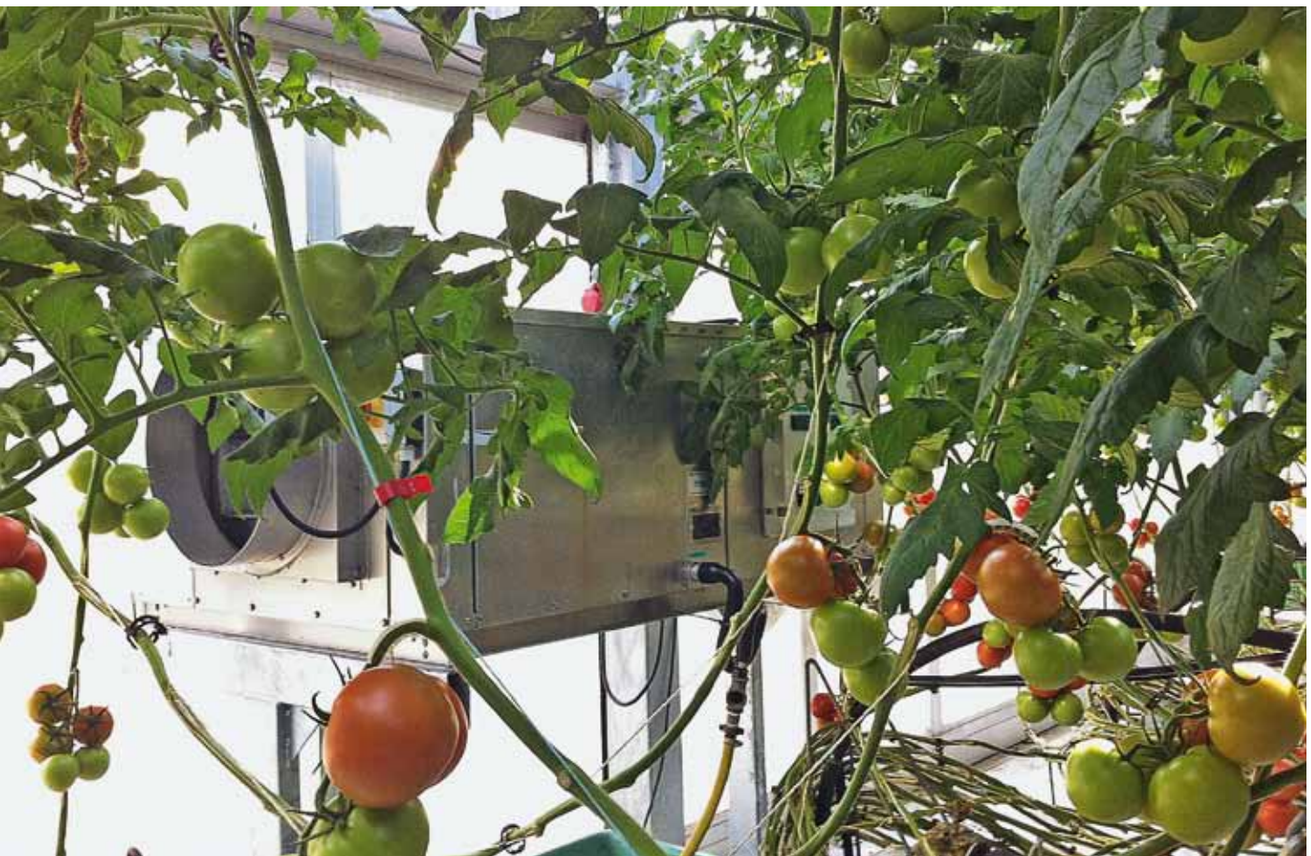
Déshumidificateur thermodynamique placé en fond de serre.
