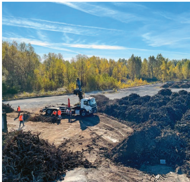
Plateforme de transformation de Saint-Christoly-de-Blaye (Gironde). Photo : Vinea Énergie.
