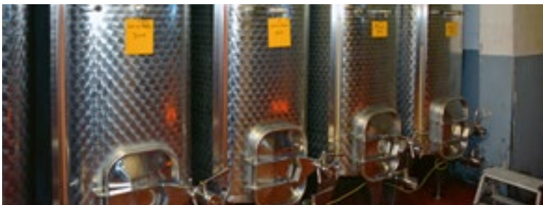
Captage de CO 2 à la source. Le gaz produit est directement évacué à l'extérieur du bâtiment.
