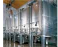
Cuves en inox
