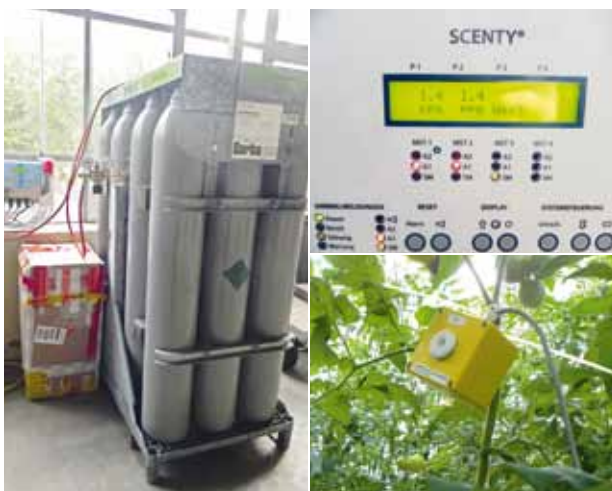
Figure 1 | Installation pour l'injection de l'éthylène: bouteilles de gaz, appareil de régulation de l'injection et capteur installé dans la culture.
