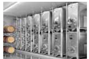
Cuverie de haute Qualité
